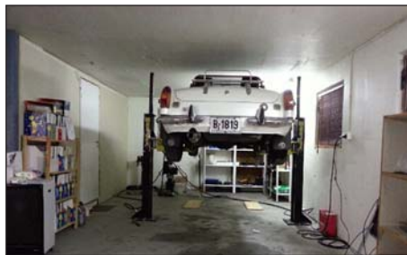
To-søyler løftebukk er innstallert på senteret slik at medlemmene også kan inspisere og utføre reparasjoner under bilen. En drøm for mange av senterne i klubben som selvsagt misunner Rogaland senter hva de har og hva de har skapt.
